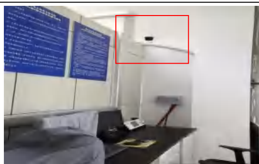
控制室摄像头
