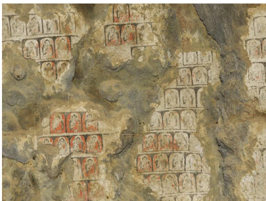
图二 崖壁壁画地仗层脱落
