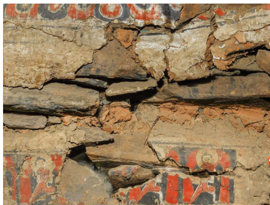
图三 隔墙壁画地仗层脱落
